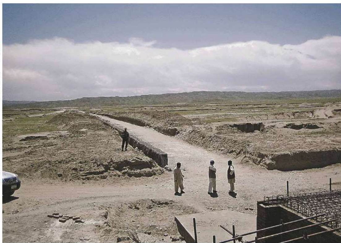
用水路の工事現場。ガンベリ砂漠の地平線にむかってまっすぐのびています。=PMS提供
